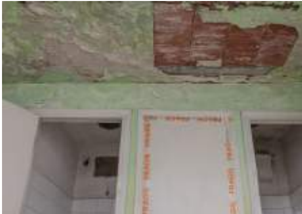
Foto 6.4.15 - Pérdida de acabado en el techo
