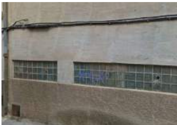
Foto 6.5.19 - Pavés de la fachada sur de la nave 2
