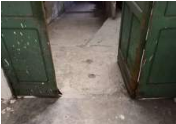
Foto 6.5.11 - Manchas de pintura y erosión de la madera (PO-2.02)
