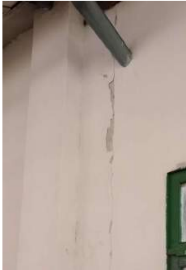
Foto 6.3.13 - Fisura en el tabique entre PO-2.01 y PO-2.02
