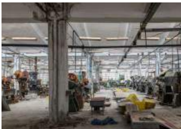
Foto 6.6.17 - Humedades en arranque y cabeza de pilares
