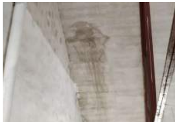
Foto 6.7.12 - Manchas por filtraciones en la cubierta (P1-2.01)
