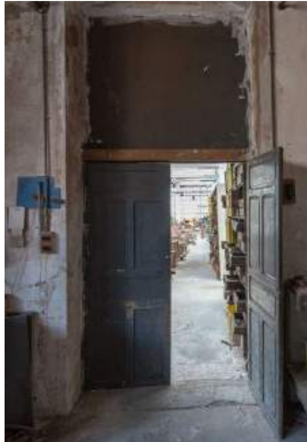
Foto 6.5.13 - Desgaste de madera, erosión de suelo (PO-3.01)
