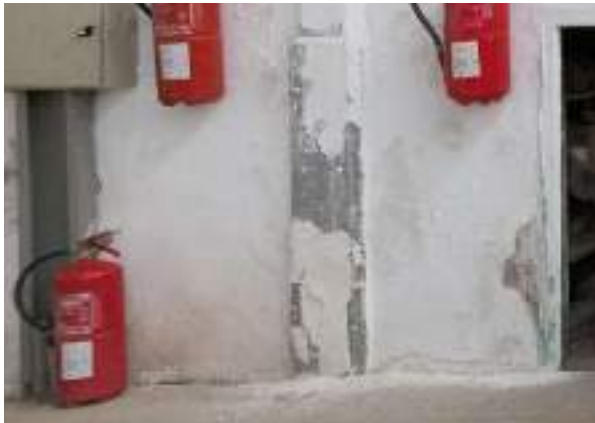
Foto 6.3.9 - Humedades y pérdida de acabado (PO-2.01)
