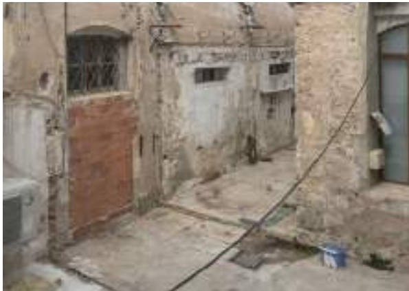
Foto 6.3.36 - Muros parcialmente sin revestimiento en patio 1
