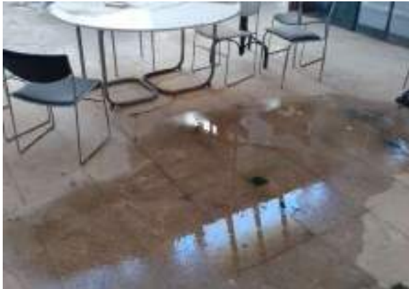
Foto 6.7.8 - Charco producido por la entrada de agua en PE-2.01
