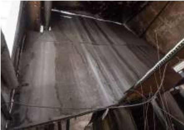
Foto 6.3.21 - Suciedad, erosión de paramentos
