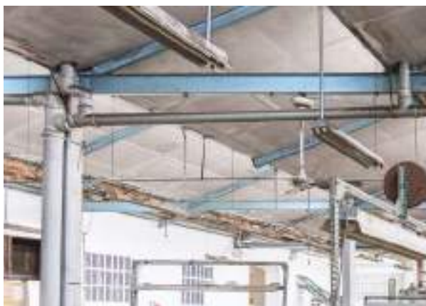
Foto 6.8.1 - Colector y bajantes en la sala PO-2.01
