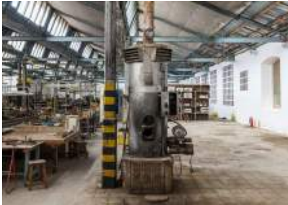
Foto 6.8.9 - Instalación en la sala P0-2.01
