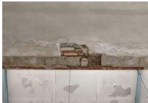
Foto 6.6.8 - Pérdida de acabado en techo, humedades
