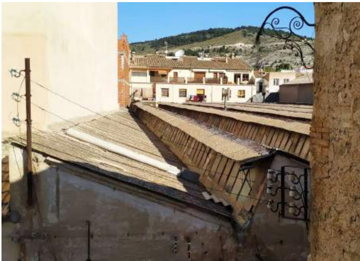
Foto 6.7.6 - Huecos de ventana en cubierta (nave 2)
