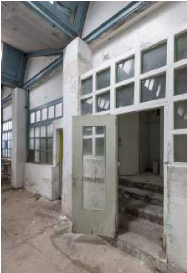
Foto 6.5.12 - Madera de puerta hinchada por la humedad (PO-2.13)
