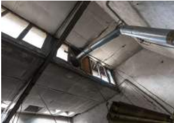
Foto 6.5.8 - Pérdida de vidrios, deterioro de carpinterías (PO-2.02)
