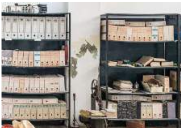
Foto 6.3.4 - Pérdida de acabado por humedad en pared (PE-2.01)
