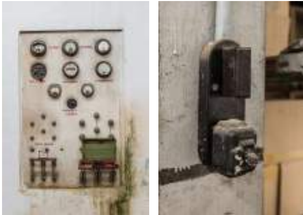
Foto 6.8.7 - Panel de control e interruptor en sala P0-2.01
