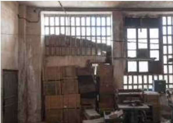
Foto 6.3.22 - Manchas, desprendimientos de acabado
