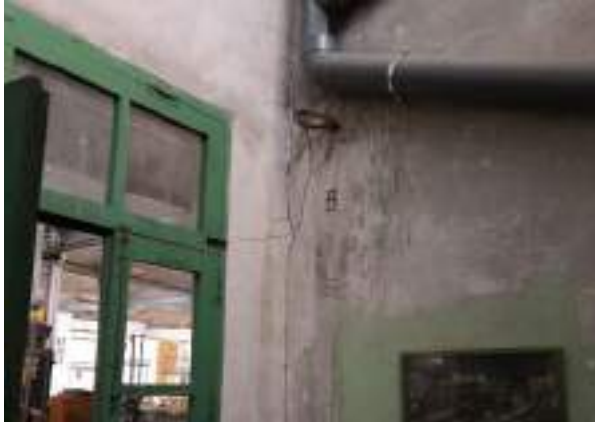
Foto 6.3.16 - Fisuras, cambio de instalaciones, suciedad
