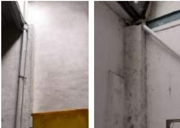
Foto 6.3.17 - Suciedad, fisuras en encuentros, corrosión en viga met.
