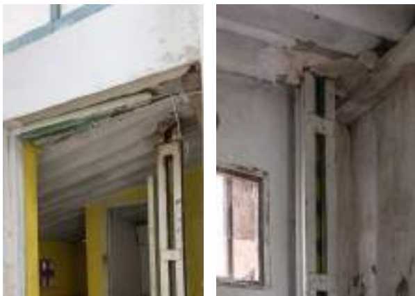
Foto 6.4.14 - Grietas, fibrocemento, escombros, humedades, etc.
