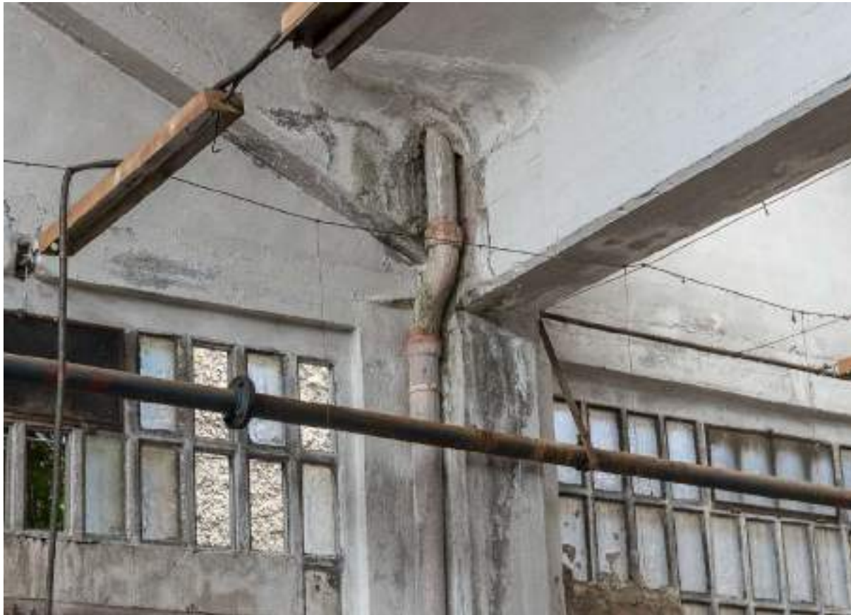
Foto 6.7.19 - Foco de humedades en la intersección de la bajante con la cubierta
