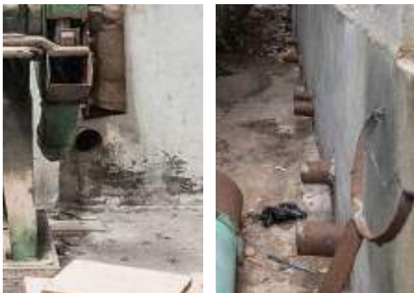
Foto 6.8.6 - Tubos en el muro de la fachada oeste de la sala PO-4.01
