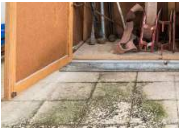
Foto 6.2.5 - Terrazo con manchas (P0-2.01)
