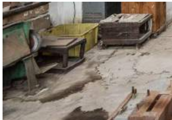
Foto 6.2.12 - Suciedad y manchas en hormigón (PO-4.01)
