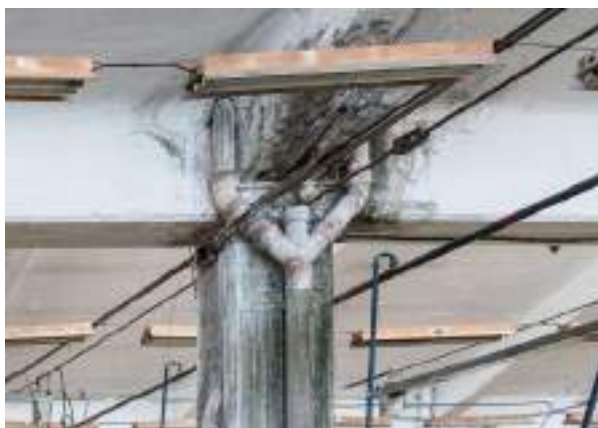
Foto 6.8.2 - Bajante en la sala PO-4.01
