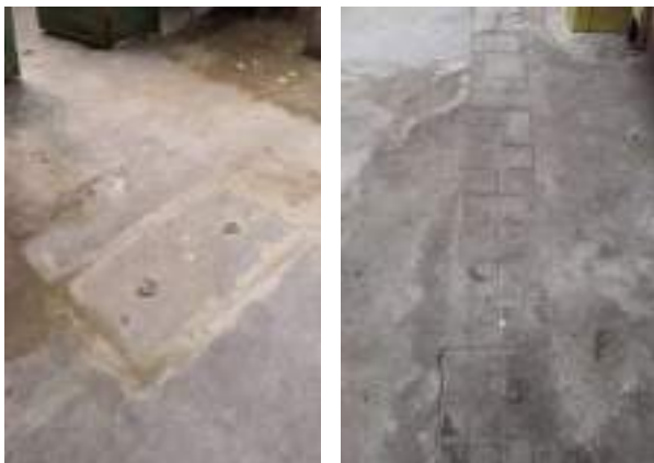
Foto 6.2.9 - Manchas, erosión del suelo, cambio de pavimento
