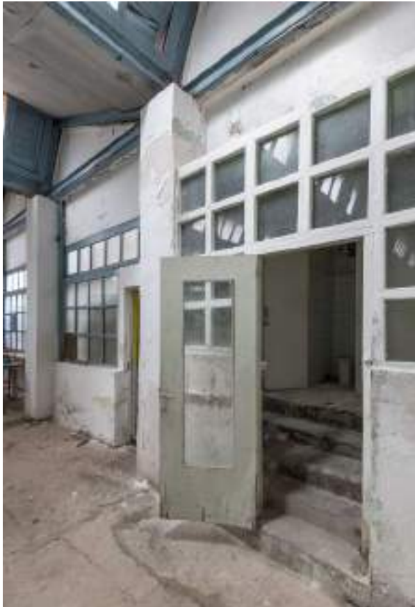
Foto 4.2.1.12 - Desnivel de acceso a la sala PO-2.13
