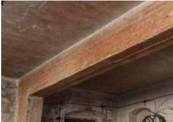
Foto 6.4.17 - Manchas en la sala PO-3.01
