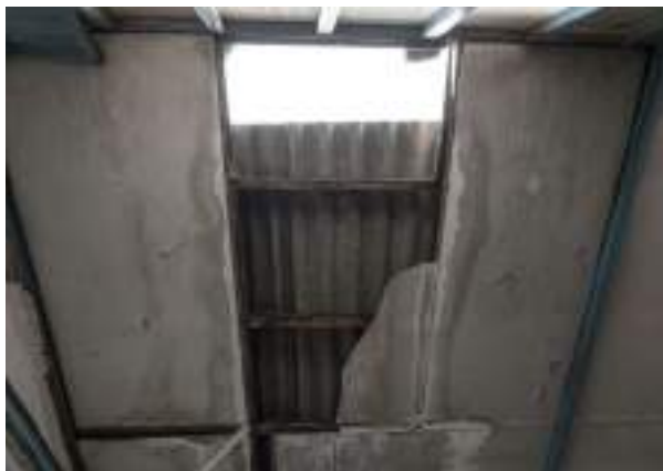
Foto 6.4.12 - Pérdida de falso techo, cubierta
