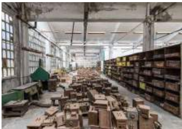
Foto 6.6.14 - Manchas y humedades en vigas y pilares (PO-4.01)
