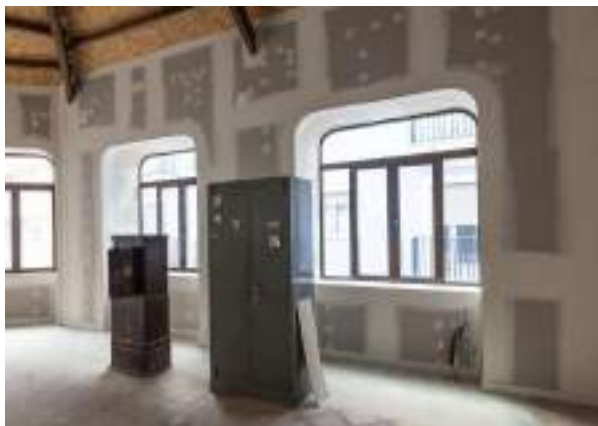
Foto 6.3.3 - Paramentos sin revestimiento (R0) en PE-1.01
