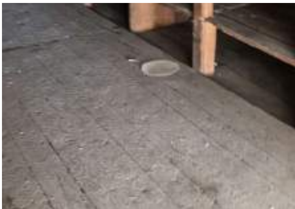
Foto 6.2.11 - Suciedad y erosión en pavimento de madera (PE-3.01)
