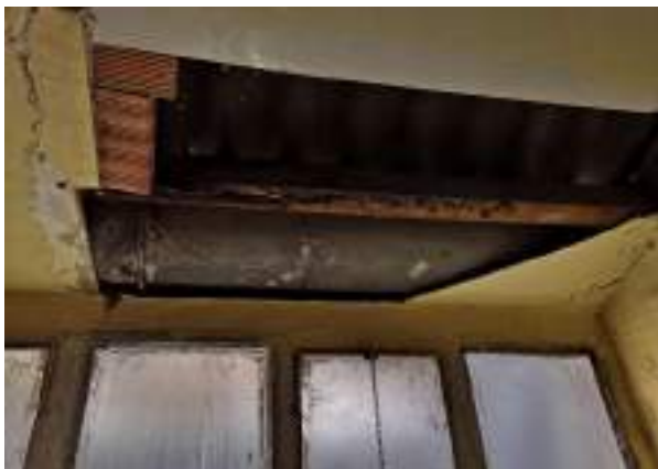
Foto 6.4.16 - Humedades, pérdida de falso techo
