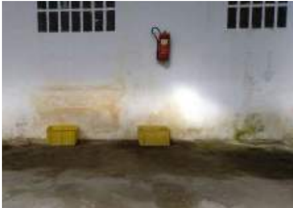
Foto 6.3.10 - Humedades en el muro que separa las naves 2 y 3
