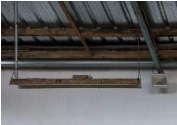
Foto 6.8.4 - Luminaria de la fabrica y foco actual en la sala PO-2.01
