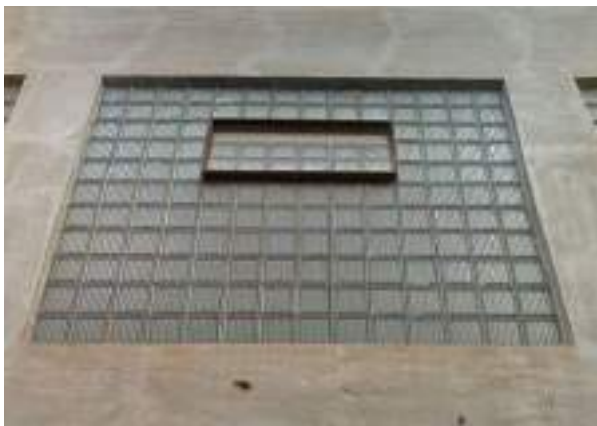
Foto 6.5.3 - Pavés en fachada sur
