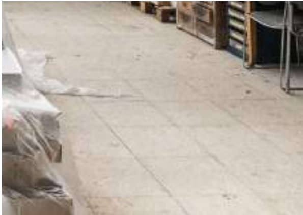
Foto 6.2.4 - Terrazo con deslustrado y suciedad (PE-2.01)
