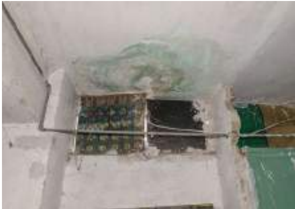
Foto 6.4.13 - Manchas de humedades en techo
