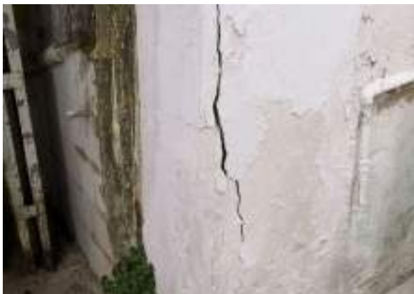
Foto 6.3.19 - Grieta, humedad, vegetación
