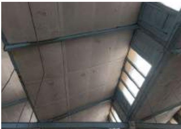
Foto 6.6.6 - Humedad en cabezas de vigas
