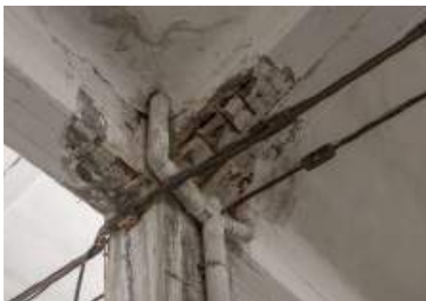
Foto 6.6.15 - Desprendimiento de hormigón, oxidación de armaduras
