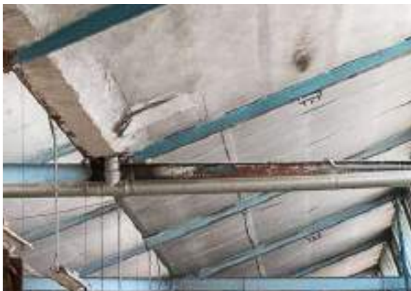
Foto 6.6.5 - Oxidación en vigas (cercano a puntos singulares)
