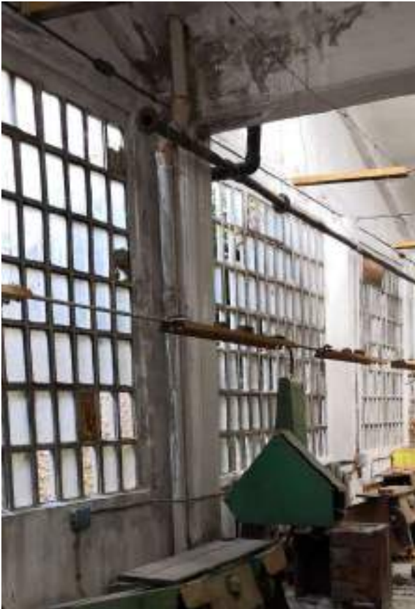
Foto 6.3.23 - Humedades, suciedad, rotura de vidrios
