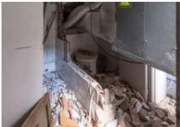
Foto 6.3.7 - Humedades, derribo de paramento vertical
