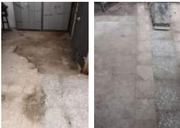
Foto 6.2.7 - Terrazo con desgastado, piezas rotas, cambio de pavim.
