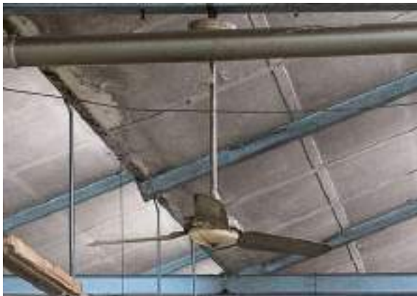
Foto 6.8.8 - Ventilador de techo en sala P0-2.01
