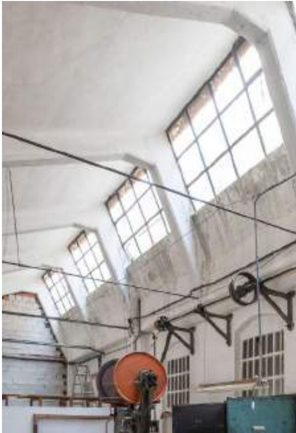
Foto 6.5.16 - Humedades bajo las carpinterías de cubierta (PO-4.01)
