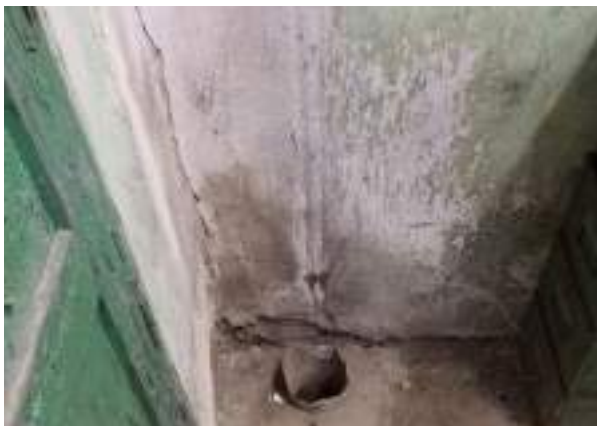
Foto 6.3.15 - Humedades, erosión de suelo y pared
