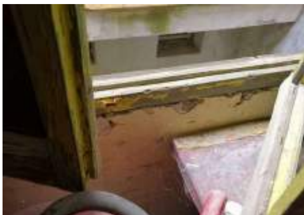
Foto 6.3.5 - Erosión en paramento vertical bajo carpintería (PE-2.02)
