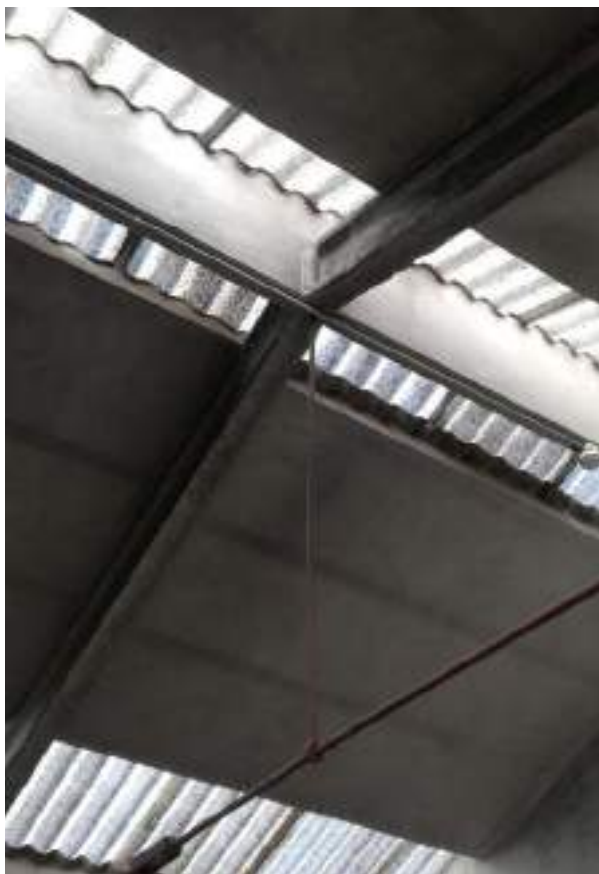
Foto 6.7.13 - Huecos en cubierta de la nave 3
