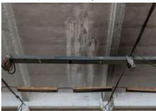
Foto 6.6.16 - Filtraciones y manchas
