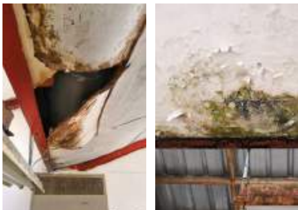
Foto 6.4.9 - Desprendimiento de falso techo y humedades
