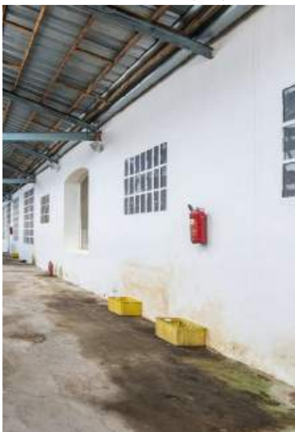
Foto 6.7.7 - Manchas producidas por el agua que entra de cubierta
