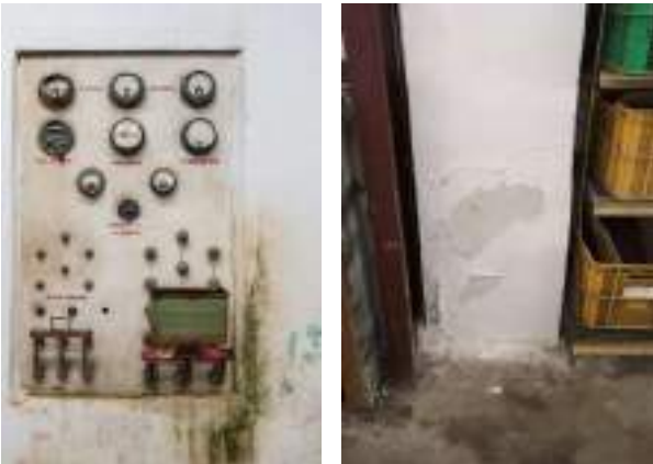
Foto 6.3.11 - Manchas y desprendimientos por humedad (PO-2.01)
