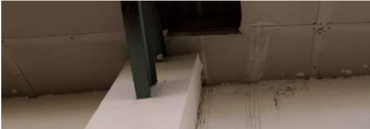
Foto 6.3.14 - Manchas de escurritía / pérdida de falso techo
