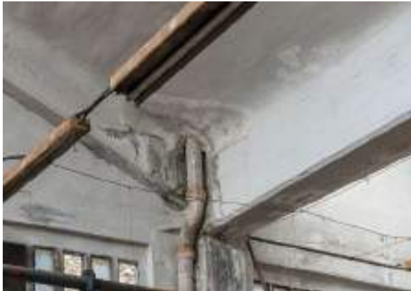
Foto 6.4.19 - Afecciones en torno a las bajantes
