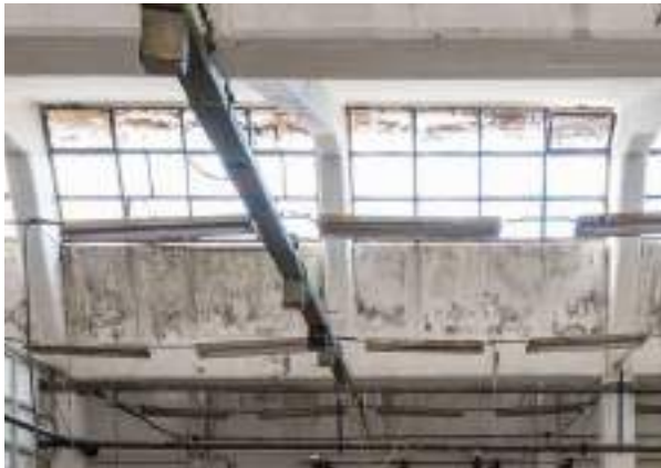
Foto 6.4.18 - Manchas de humedades y desprendimientos
