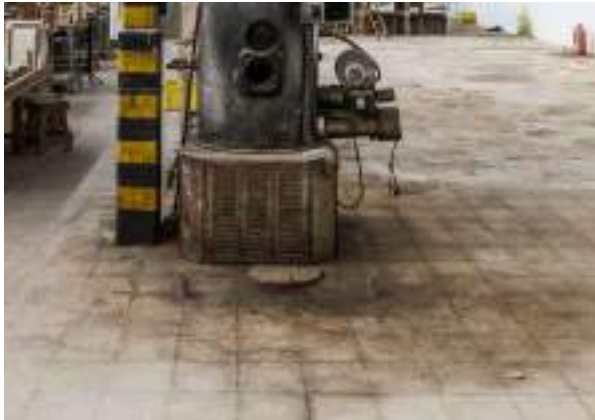
Foto 6.2.6 - Terrazo con manchas producidas por instalaciones
