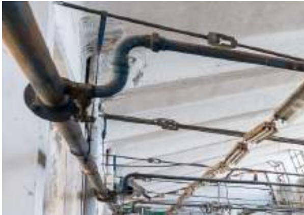
Foto 6.8.5 - Instalación para la maquinaria de la sala PO-4.01
