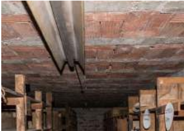
Foto 6.6.12 - Forjado de viguetas al descubierto en la sala PO-3.02
