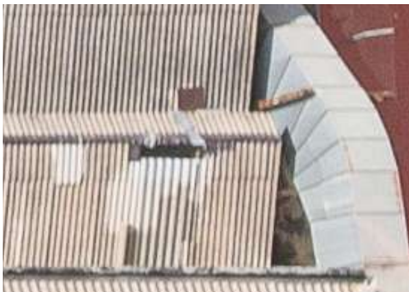
Foto 6.7.4 - Desprendimiento de cubierta en la nave 2
