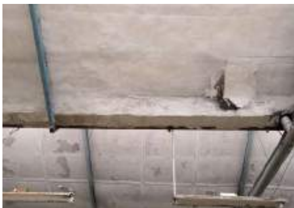
Foto 6.4.10 - Techo con humedades
