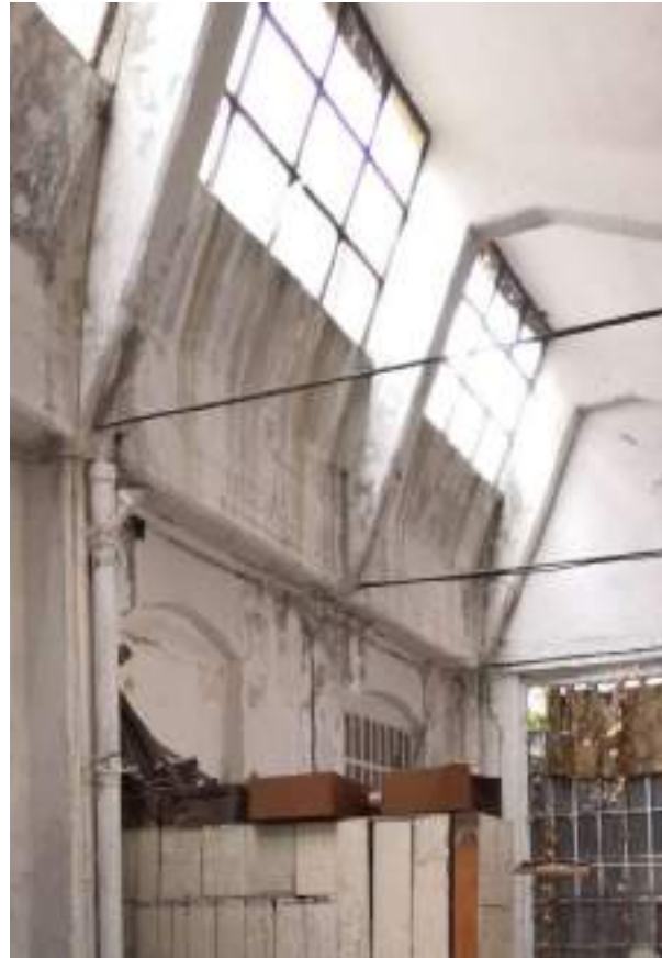
Foto 6.3.24 - Humedades y manchas producidas por carpintería
