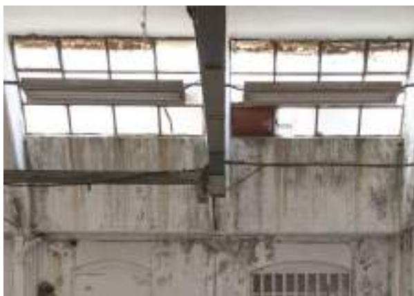
Foto 6.7.18 - Manchas de escorrentía en la cubierta de la nave 4
