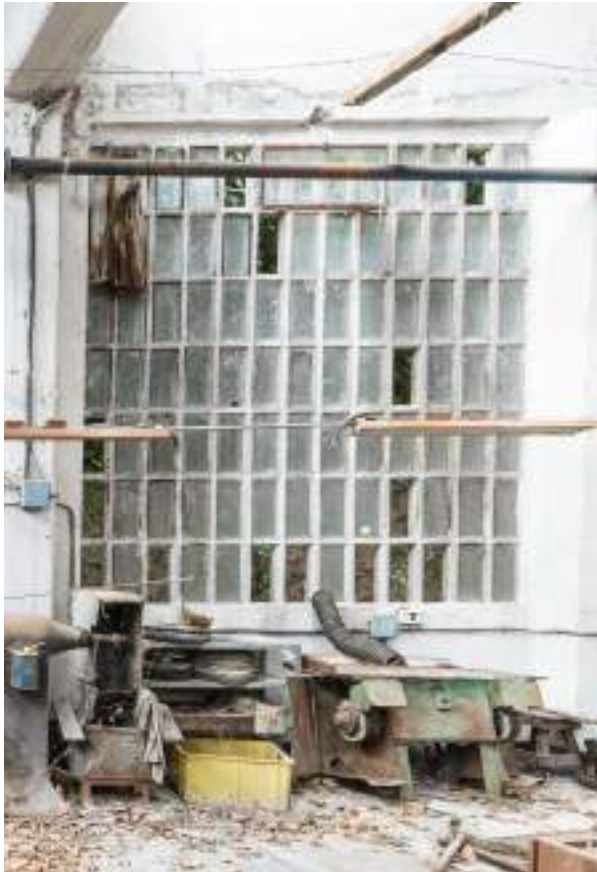
Foto 6.5.17 - Carpinterías con falta de vidrio en la sala PO-4.01
