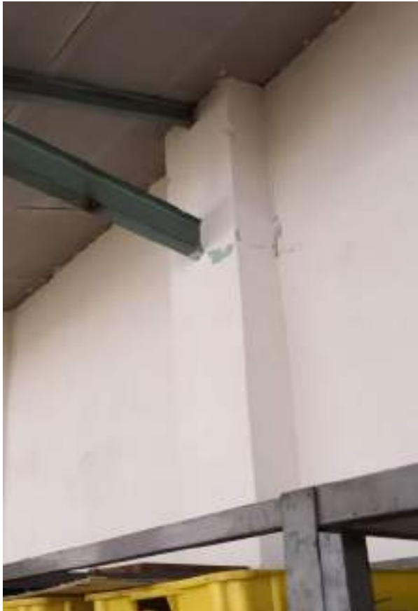
Foto 6.3.12 - Fisura en cambio de paramento (PO-2.01)
