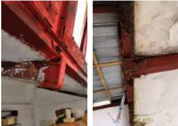
Foto 6.6.4 - Manchas de pintura, oxidación, pérdida de acabado.
