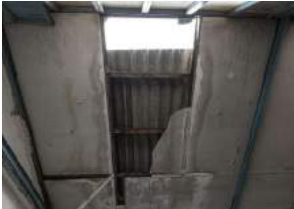
Foto 6.6.9 - Pérdida de cubierta, subestructura con humedades
