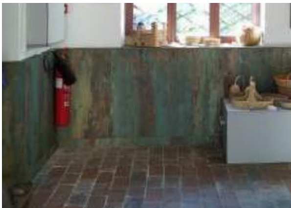
Foto 6.3.28 - Zócalo de alicatado (R5) en P1-01
