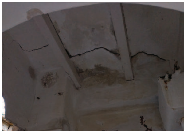
Foto 6.6.4 - Entrevigados de ladrillo cerámico con grietas
