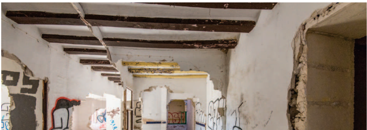
Foto 6.6.3 - Vigas de madera con xilófagos
