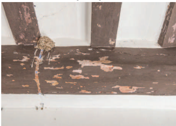
Foto 6.4.5 - Vigas suciedad y pintura desconchada y agrietada
