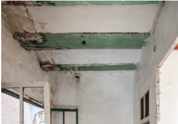
Foto 6.4.6 - Viga y entrevigado con humedad. Madera putrefacta
