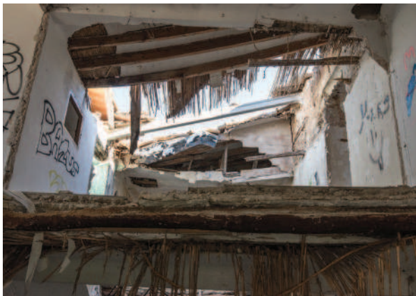
Foto 1.6 - Foto de la cubierta caída
