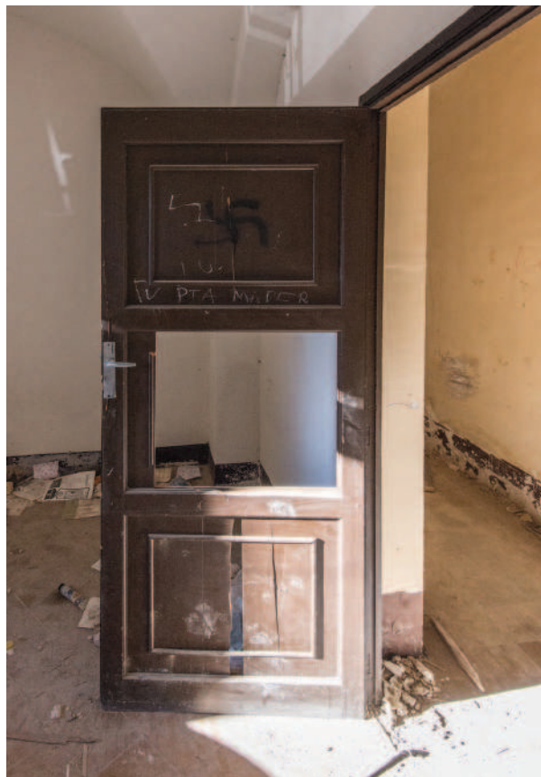
Foto 6.5.6 - Puerta con partes rotas
