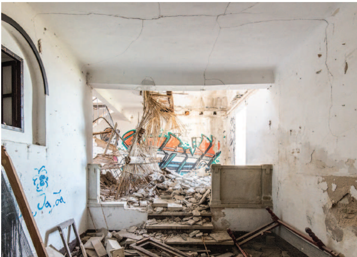
Foto 6.4.4 - Falso techo con grandes grietas
