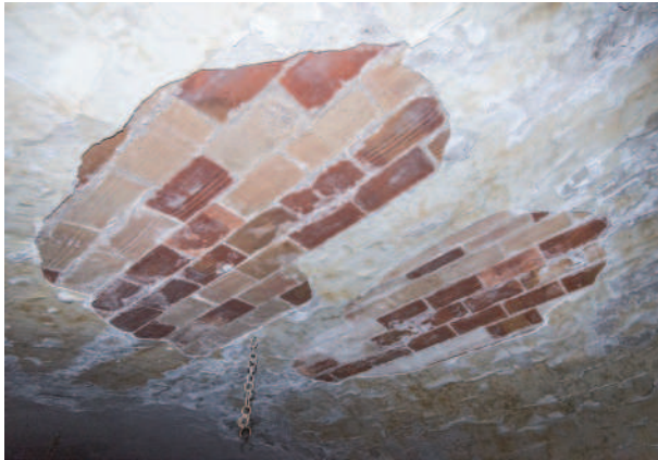
Foto 6.4.3 - Bóveda de cañón con pérdida de pintura y yeso
