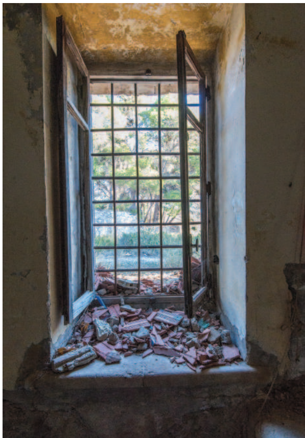
Foto 6.5.4 - Ventana con reja. Partes rotas, sin vidrio, hierro oxidado
