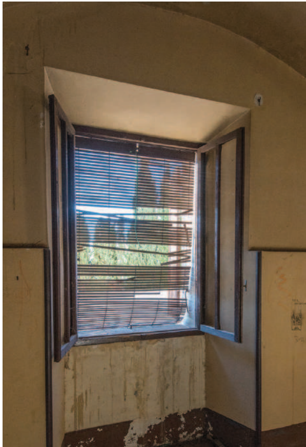
Foto 6.5.3 - Ventana de fachada con persiana rota, sin vidrio
