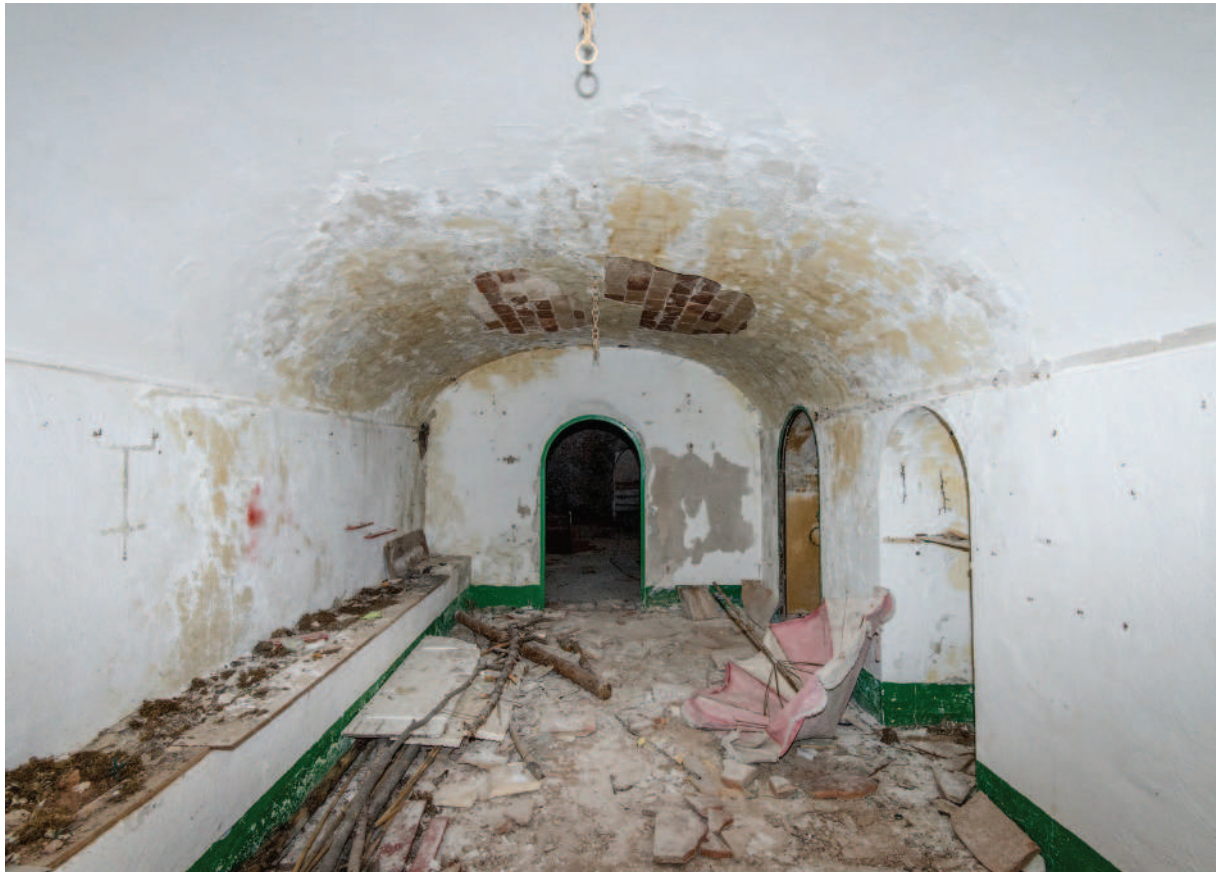
Foto 6.4.2 - Bóveda de cañón con pérdida de pintura y yeso y humedad
