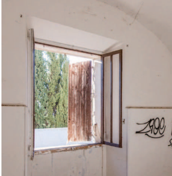
Foto 6.5.1 - Ventana de fachada con contraventana de madera. Pérdida de pintura, sin vidrio y xilófagos
