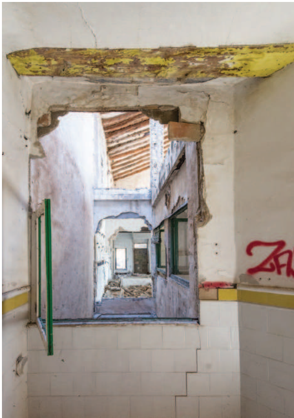
Foto 6.4.7 - Viga de madera con xilófagos y pérdida de pintura
