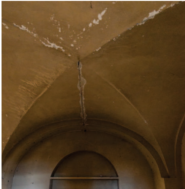
Foto 6.4.1 - Bóveda de arista, pintura y yeso desconchado
