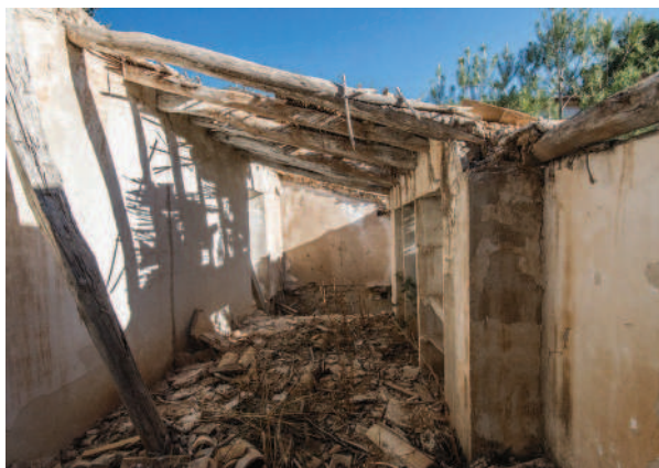
Foto 6.6.10 - Vigas de madera que han colapsado parcialmente
