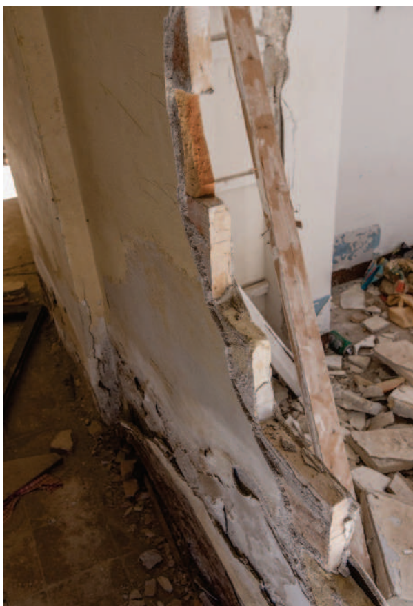
Foto 6.3.1 - Tabique ladrillo cerámico macizo derruido parcialmente
