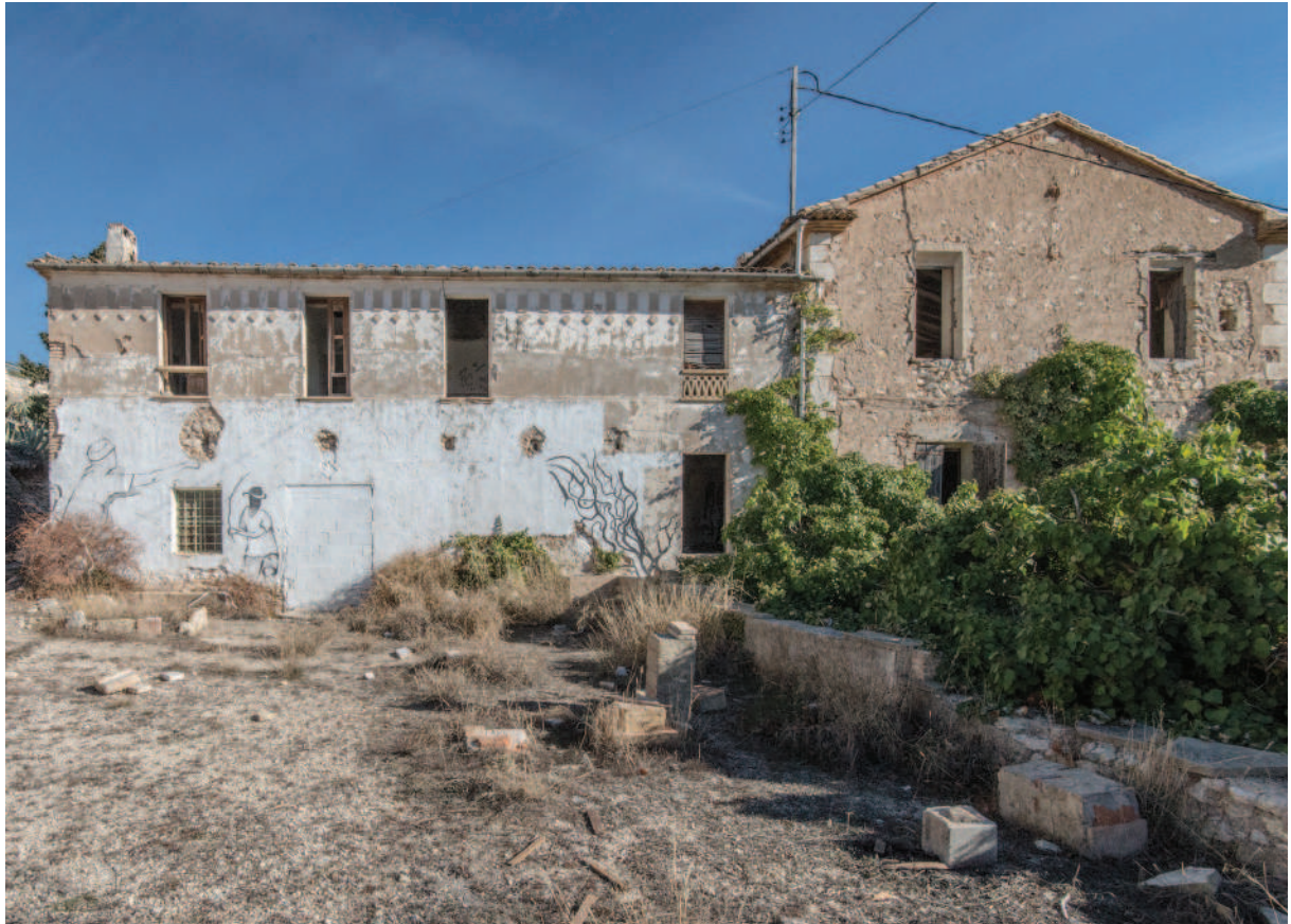
Foto 6.3.5 - Fachada con muro de piedra visto y acabado continuo y huecos por falta de piezas
