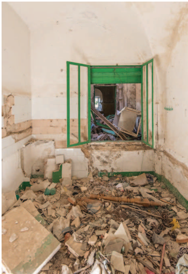
Foto 6.3.4 - Acabado de azulejo con falta de piezas y piezas rotas
