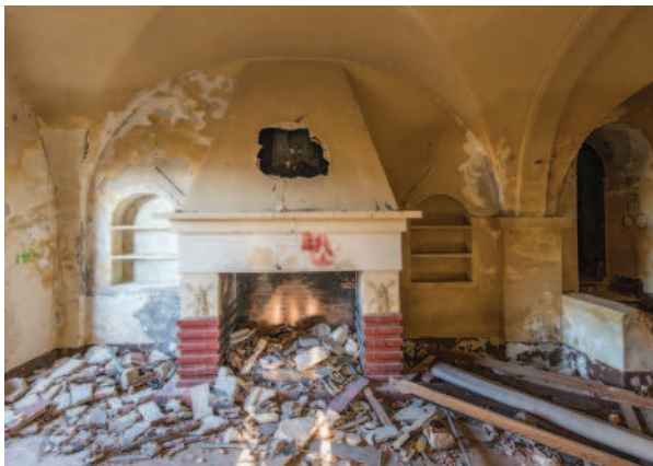
Foto 4.3.1.1 - IO - 12.B) Chimenea
