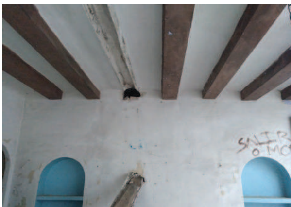
Foto 6.6.5 - Colapso de viga de madera por humedad y putrefacción
