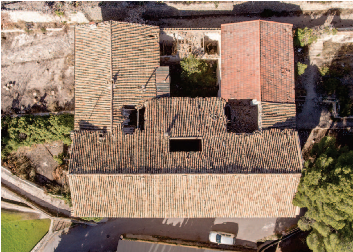
Foto 6.7.1 - Cubiertas con zonas colapsadas y falta de piezas
