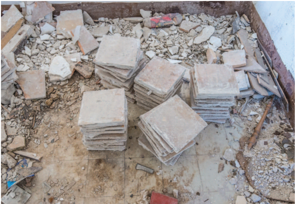
Foto 6.2.5 - Baldosas hidráulicas arrancadas
