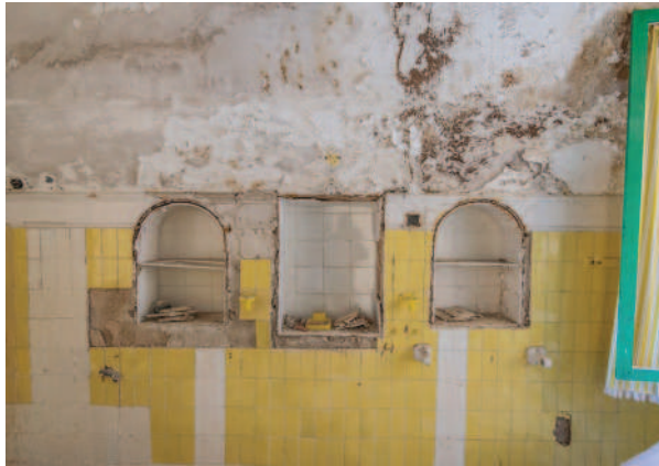
Foto 6.3.3 - Paramento con humedades
