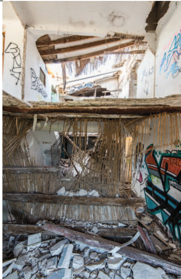
Foto 6.6.9 - Estructura de vigas de madera colapsada
