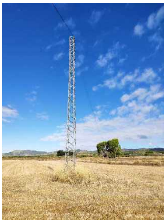
Fotografía 61 Vistas de la torre eléctrica en el paso sobre la A-7 y conexión hasta edificación. Fuente: Elaboración propia. Fecha: 08/09/2020
