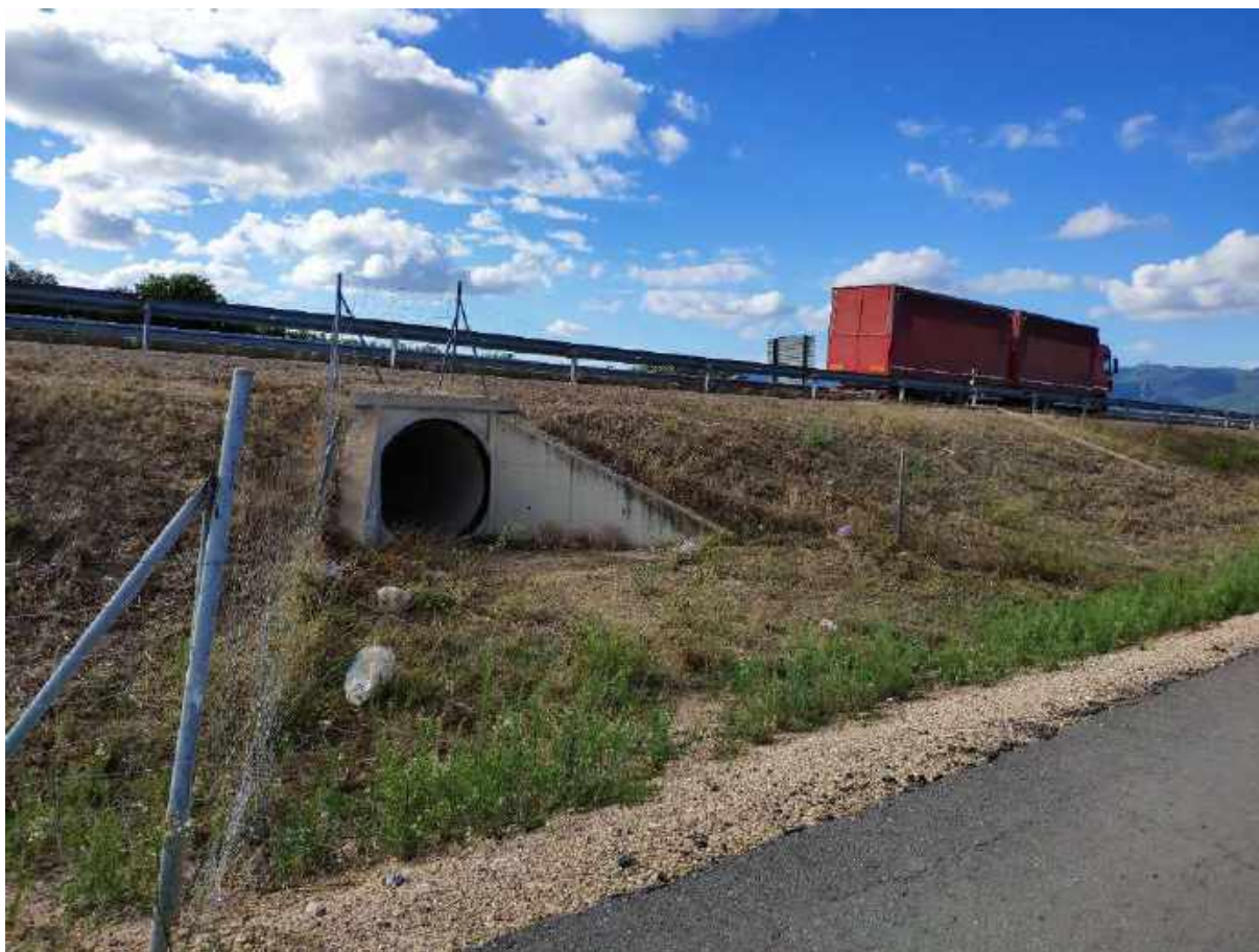
Fotografía 65 Vista de obra de drenaje transversal de la A-7 en el Sector. Fuente: Elaboración propia. Fecha: 08/09/2020
