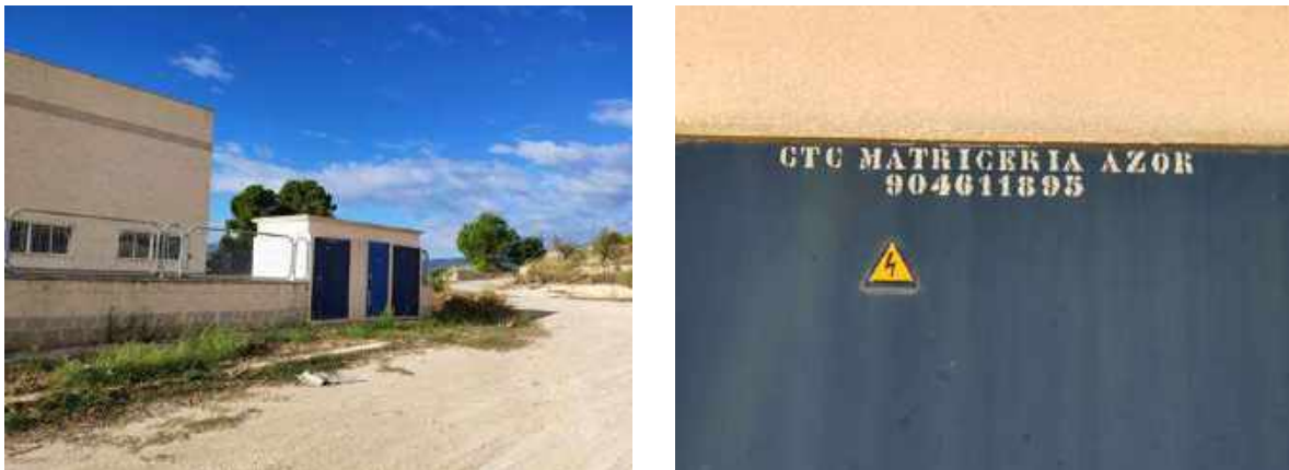
Fotografía 59 [Izquierda] Vista del Centro de Transformación en calle León. [Derecha] Vista de la referencia del C.T. Fuente: Elaboración propia. Fecha: 08/09/2020
